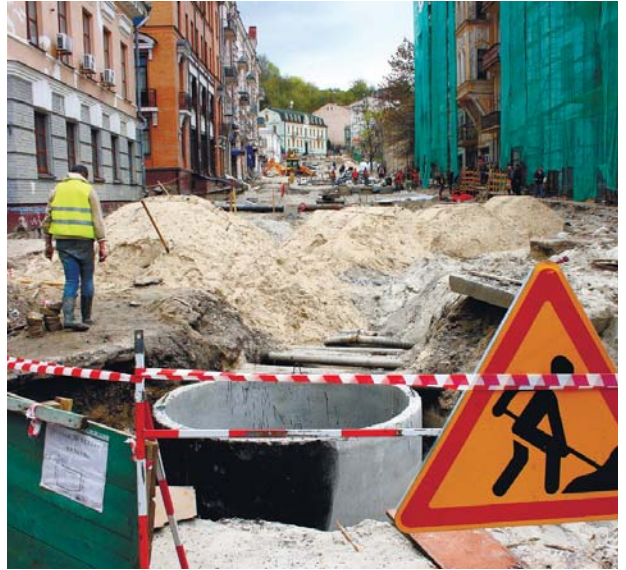
Постійне проведення ремонтів – це практично єдиний вихід, аби міста не потопали у воді
